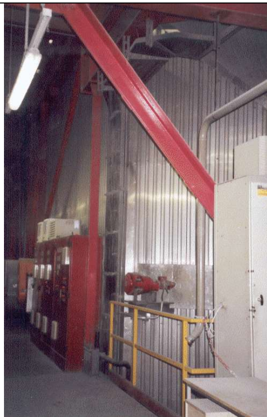
Fig.3 – O precipitador eletrostático, primeiro estágio do tratamento dos gases resultantes da queima do lixo.
